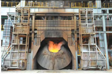
110t Elektrik Ark Fırını (EAF)
