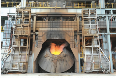
110t Elektrik Ark Fırını (EAF)
